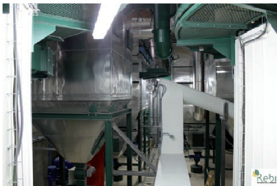
Equipos instalados para el funcionamiento de la red de distrito de Óvega (Soria).
